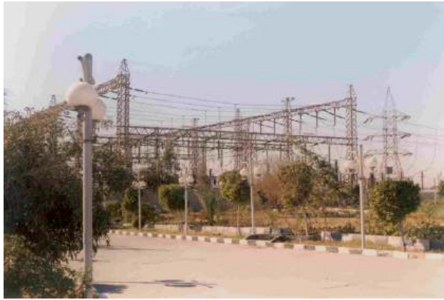
صورة ٧-٨: توضح محطات محولات الكهرباء ببني سويف الجديدة ، المصدر : هيئة المجتمعات العمرانية الجديدة - بني سويف الجديدة.
