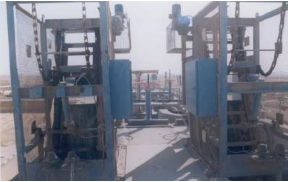
صورة ٧-١٤: توضح احدى محطات معالجة الصرف الصحي ببني سويف الجديدة ، المصدر : هيئة المجتمعات العمرانية الجديدة - بني سويف الجديدة.
